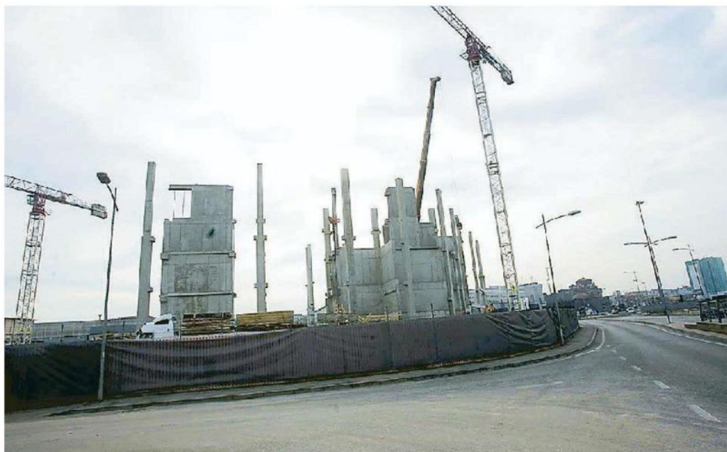
I lavori di costruzione del centro congressi in corso nell'area nord della Fiera, in via Goldoni
